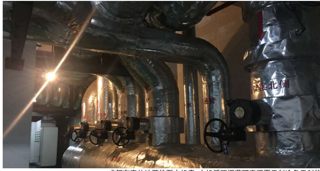
成都东客站地源热泵主机房，主机循环节约可实现夏天制冷冬天制热
