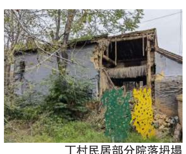
丁村民居部分院落坍塌
