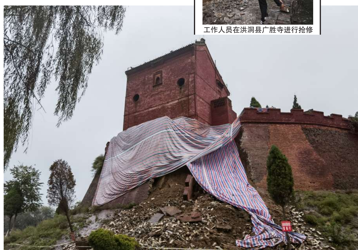
台骀庙的西北城墙倒塌
